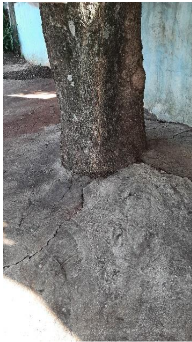
E. Exemplo de ausência de canteiro, com concreto até o colo da árvore.
