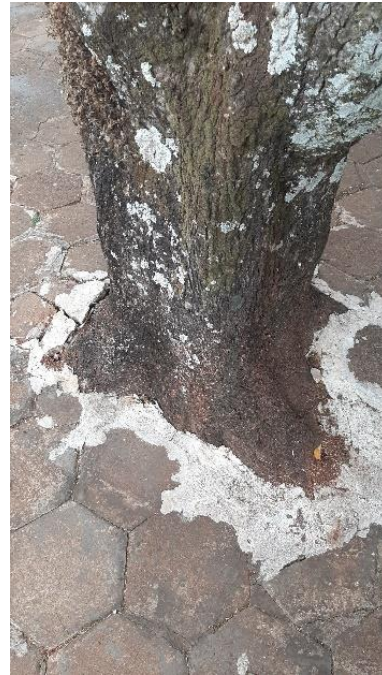
F. Exemplo de ausência de canteiro, com concreto até o colo da árvore.
