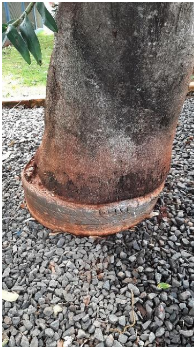
G. Exemplo de mau uso de canteiro, com um pneu constringindo o colo da árvore.
