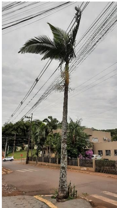
A. Exemplo de conflito com a fiação aérea.
