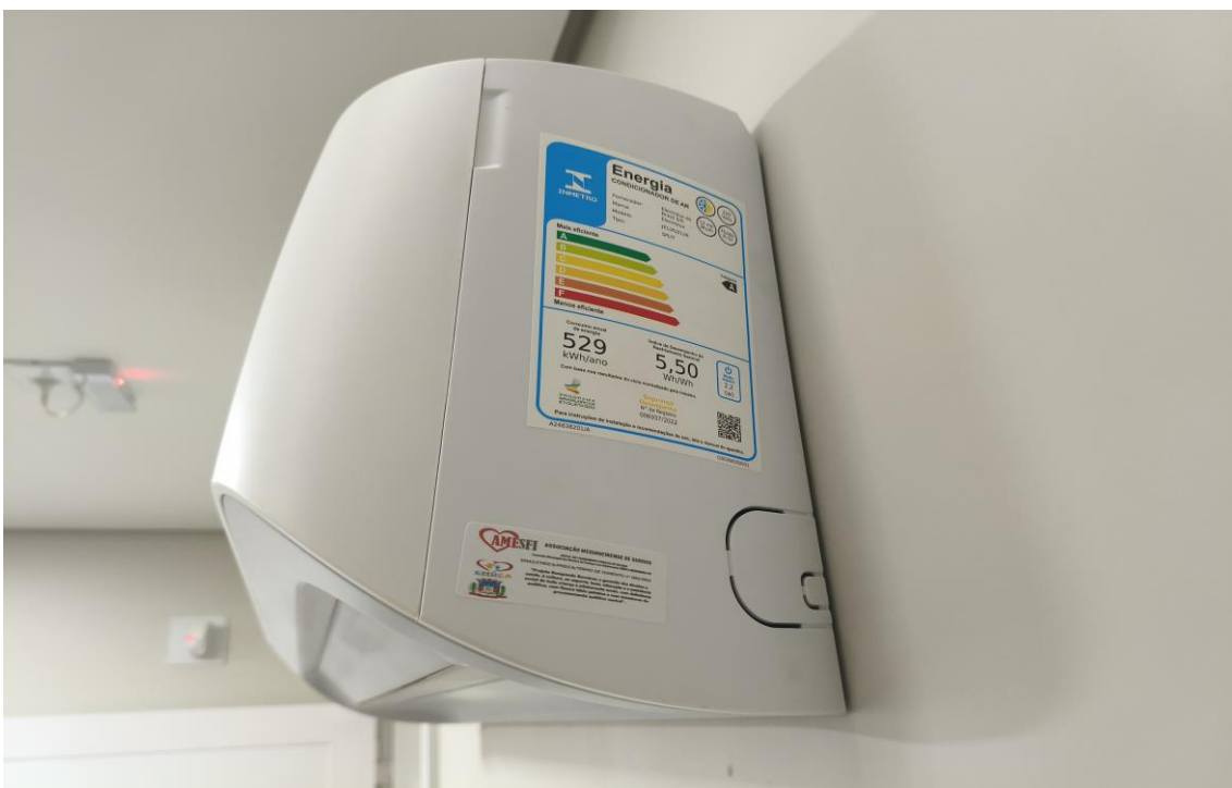
AR CONDICIONADO SALA DE ESPERA
