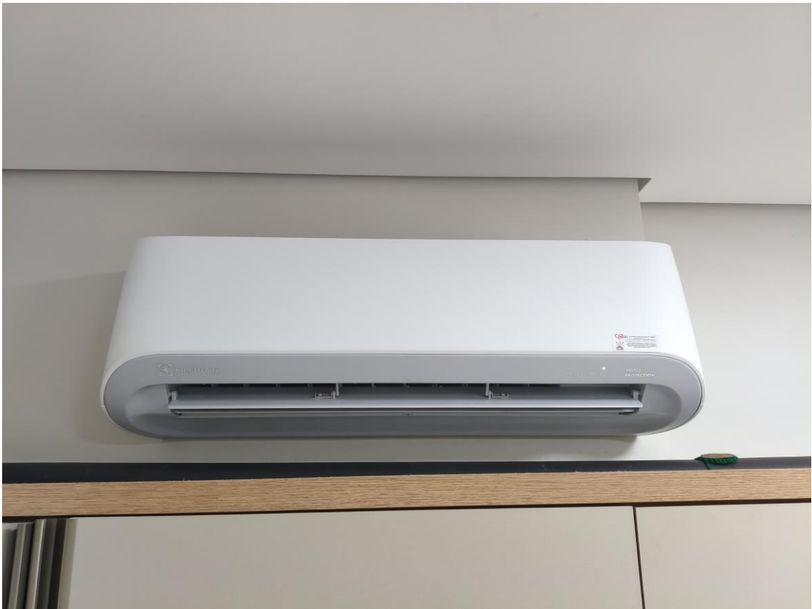
AR CONDICIONADO SALA DO PEDAGOGO
